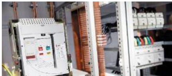
ВВОД И РАСПРЕДЕЛЕНИЕ ЭЛЕКТРОЭНЕРГИИ ДО 1 КВ
